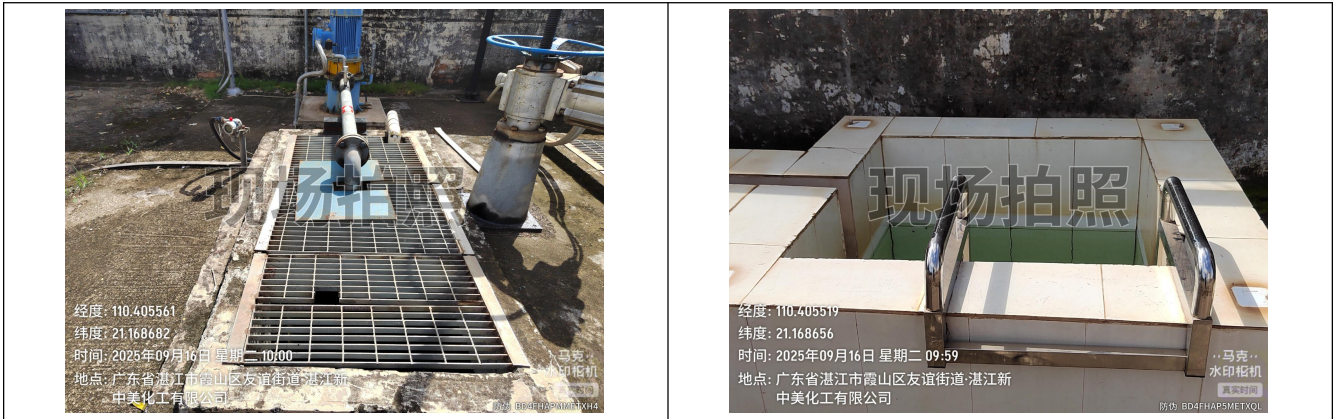
图 4.1-5 废水处理及排水系统现场照片
